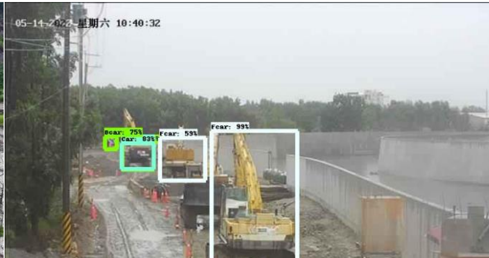
0514豪雨 臺南市仁德區-三爺溪中下游(後壁排水出口至文賢排水出口)六工區-五空橋上游
