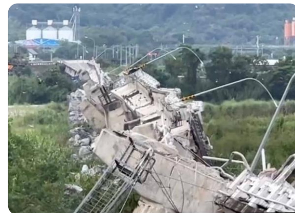
0918池上地震(2022) 花蓮玉里高寮大橋
